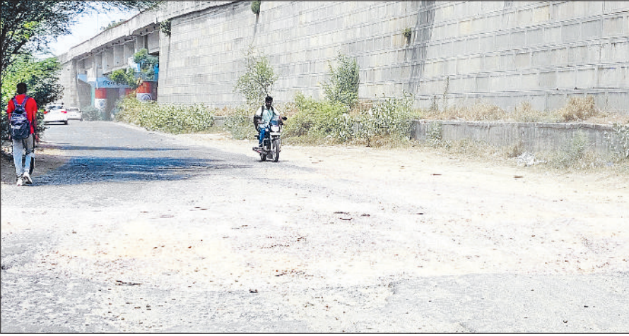
बहादुरगढ़। शहर के बाइपास की सर्विस लेन में बने गड्ढे।
